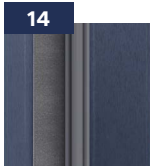
14 Uszczelka pęczniąca (drzwi PPOŻ)
